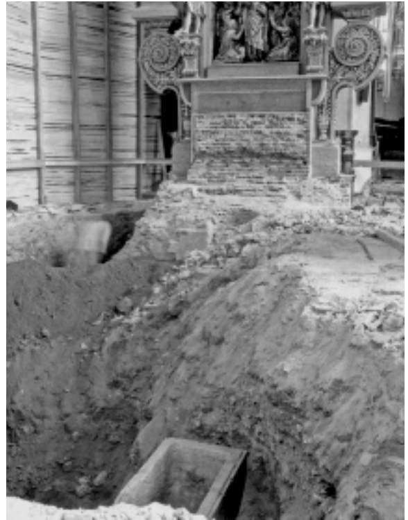
St. Ulrich und Afra: Baugrube vor dem Afraaltar mit römischem Sarkophag, Oktober 1961.
